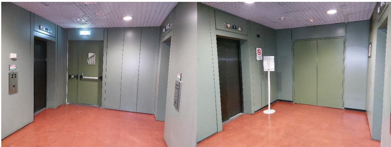
Figura 9: Immagini raffiguranti l'area di sbarco del blocco ascensori n. 3-4-5-6 (primo piano) da adibire ad area di cantiere.
