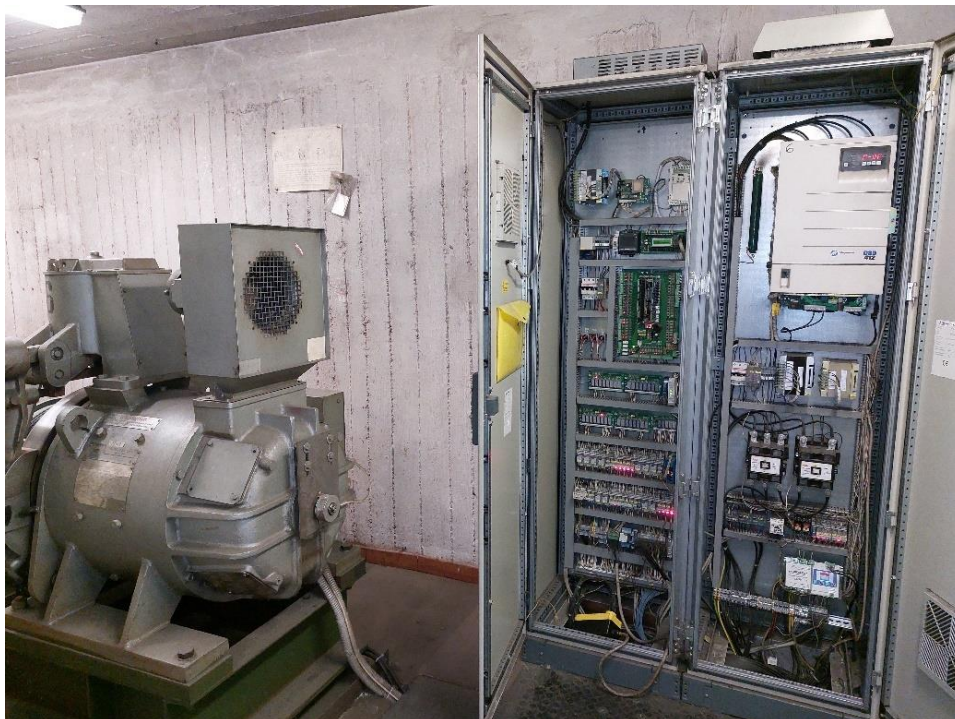
Figura 5: Foto quadro elettrico ascensore n. 6 collocato nel locale macchine collocato sulla copertura del corpo torre
