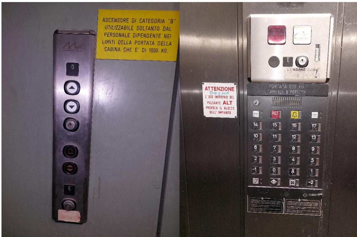
Figura 8: Esempio di bottoniera esterna di piano (sinistra) e interna di cabina (destra) ascensore n.1
