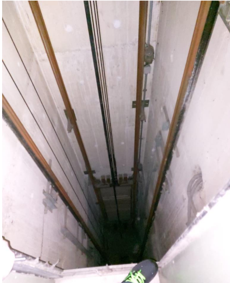
Figura 3: Foto vano corsa ascensore 2.
